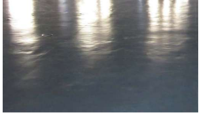
下地の凹凸がはっきりとした影となり目立つ 床下地表面凹凸:グレードD (2m直定規で隙間6mm未満)
